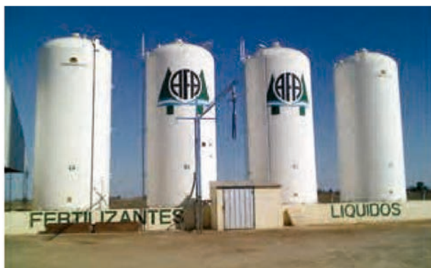
Figura 2. Tanques de gran capacidad para el almacenamiento de fertilizantes líquidos en plantas de distribución
